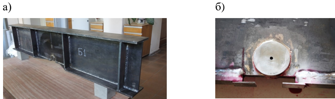
Рисунок 11 – Общий вид балочного образца после испытаний: а – образец с усталостной трещиной, локализованной постановкой двухсторонних «грибовидных» накладок; б – вид соединения после 2 млн циклов нагружения
